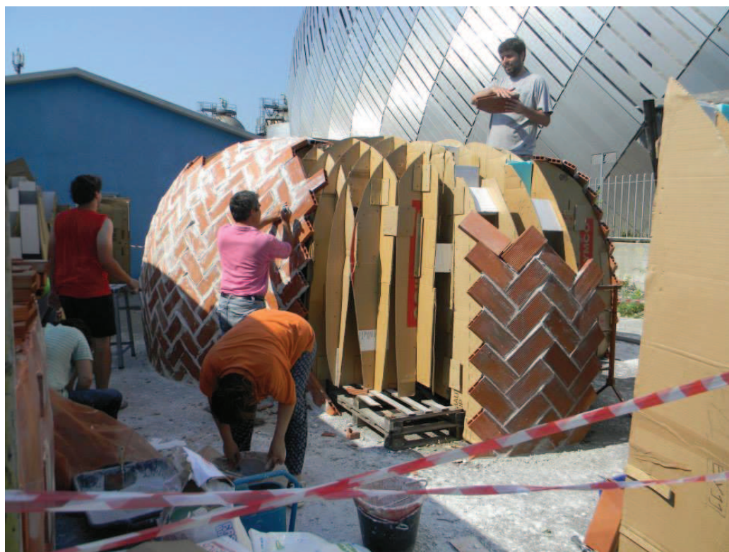
Figura 6.9: Le fasi di cantiere di BrikShell. Vengono posati mattoni seguendo la forma delle centine sottostanti in cartone.
