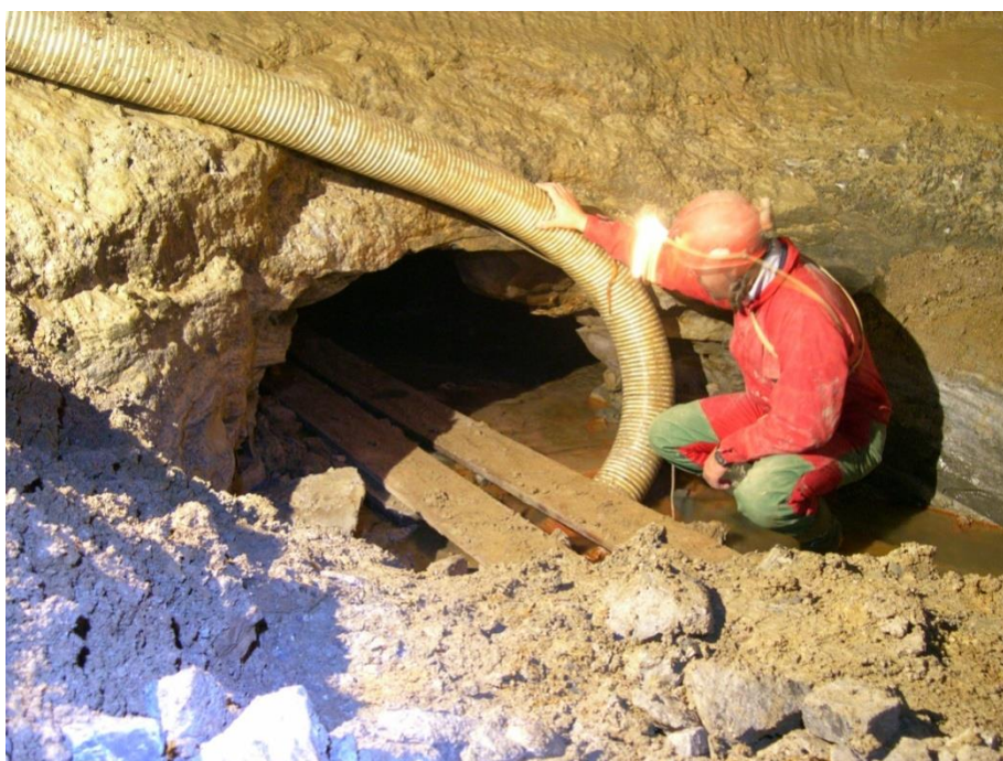
Figura 80: Punto di sfondamento del fronte di scavo
