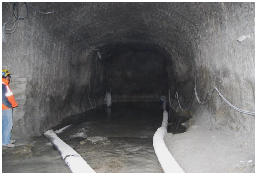
Figura 184: Bacino di raccolta d'acqua presso l'imbocco Est
