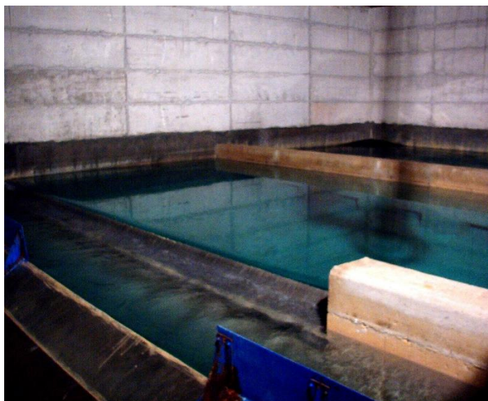
Figura 197: Vasche di carico nell'impianto di Limone Piemonte.
