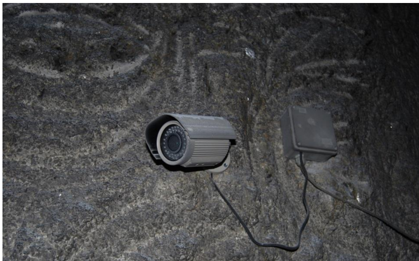
Figura 185: Telecamera per il controllo dei livelli idrici nei principali bacini
