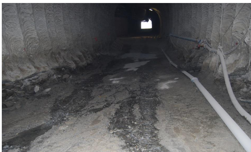
Figura 187: Tubazioni per il trasporto delle acque dai bacini alle vasche di sedimentazione
