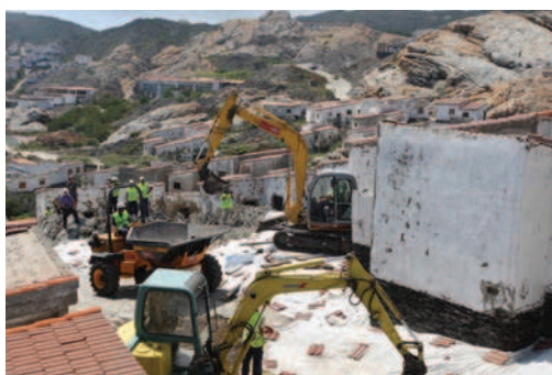
Fig. 3: Enderroc dels bungalows del Club Med (ICRPC-Lluís Serrat)
