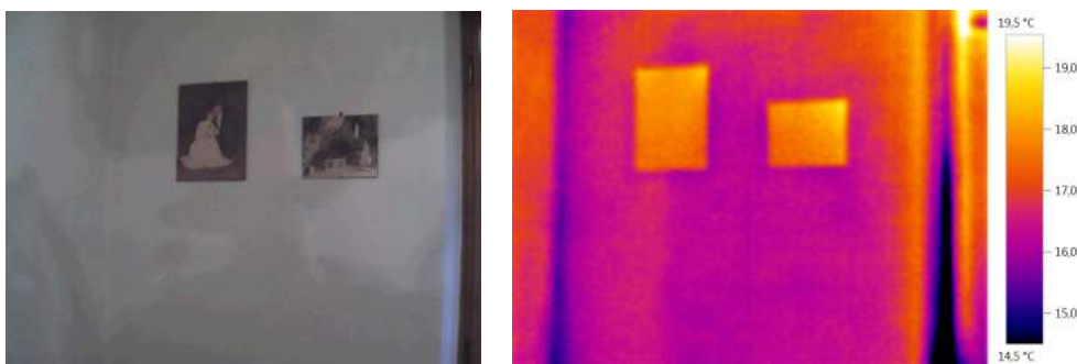
Figura 6.21: Termografia della stanza 2 prima dell'isolamento in paglia (DENERG, 19 dicembre 2013)
