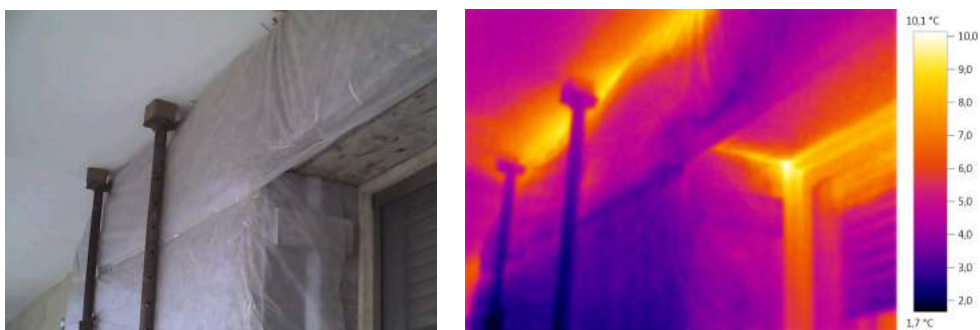
Figura 6.31: esterno stanza 2 (dopo la collocazione dell'isolamento): ponti termici costruttivi in corrispondenza dell'attacco tra chiusura verticale isolata e partizione esterna orizzontale e in prossimità dell'attacco tra isolante e apertura (L. Bianco, 13 gennaio 2014)
