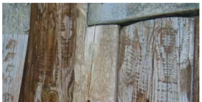
Sestriere. Rivestimenti parietali (inizio anni 2000): rottura terminale, alterazione cromatica, degrado biotico, marcescenza, distacchi.
