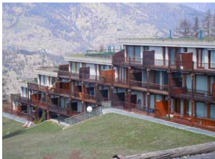
San Sicario Alto. Intelaiature, balconate (fine anni settanta): alterazioni cromatiche, abrasioni.
