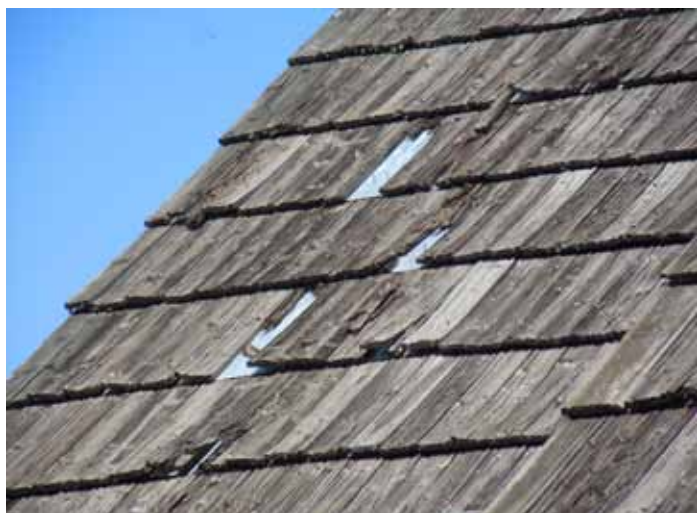
Sauze di Cesana. Scandole su lamina metallica (anni ottanta): ingrigimento, fessurazioni e distacchi.
