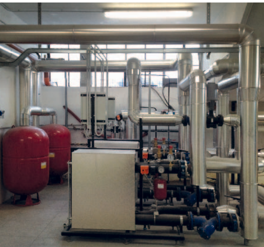
Figura 5. La centrale con gli scambiatori di calore che si interfacciano alla rete di teleriscaldamento realizzata dal comune di Rivoli
