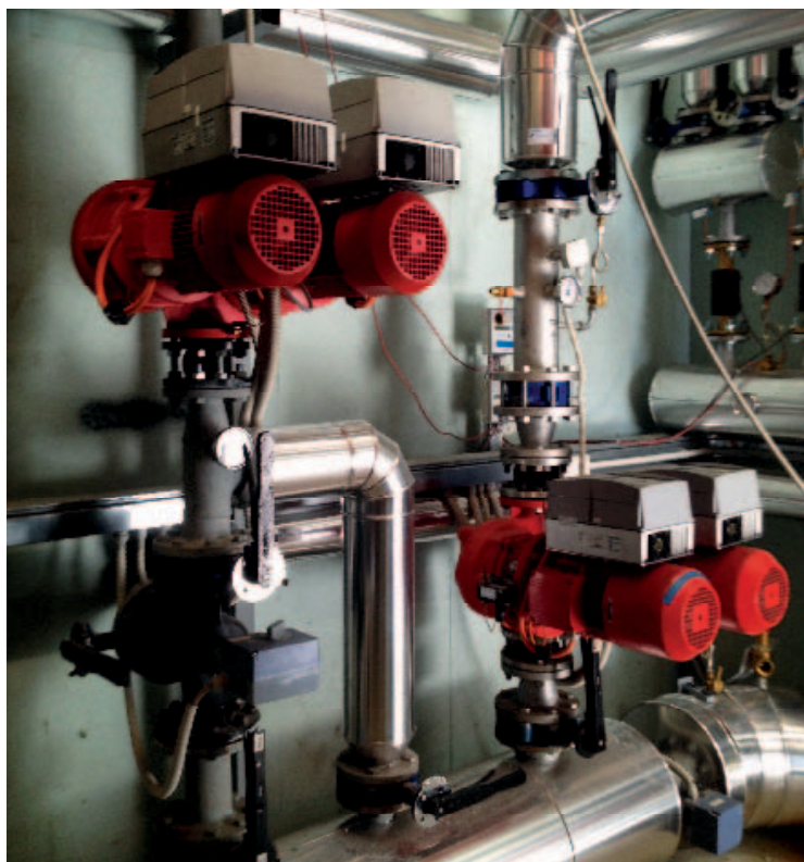
Figura 7. Un dettaglio del locale tecnico, denominato “centralina di pompaggio e smistamento”, dove sono stati collocati i collettori e le relative elettropompe
