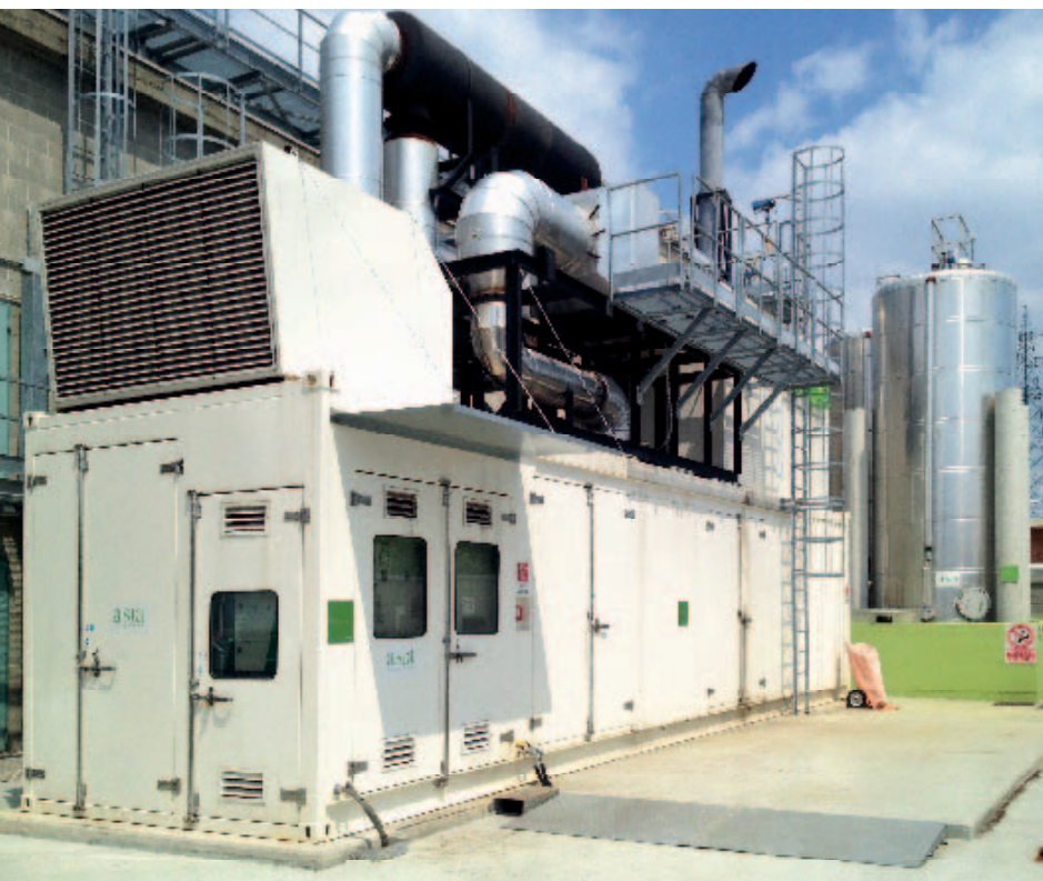
Figura 1. L'impianto di cogenerazione a olii (sia vegetali puri che esausti) che Asja ha messo in funzione contestualmente alla fase di progettazione
