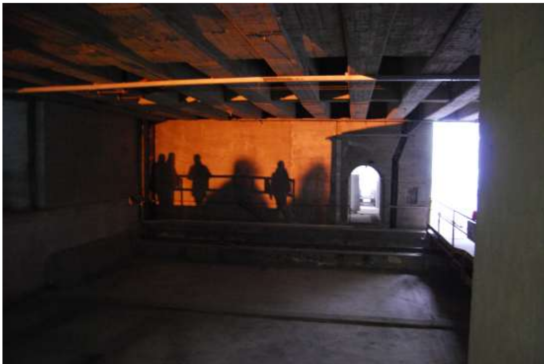
Alcuni spazi in allestimento, nei pressi della banchina del treno, nel cantiere del memoriale della Shoah alla Stazione centrale di Milano. MVG, dicembre 2011.
