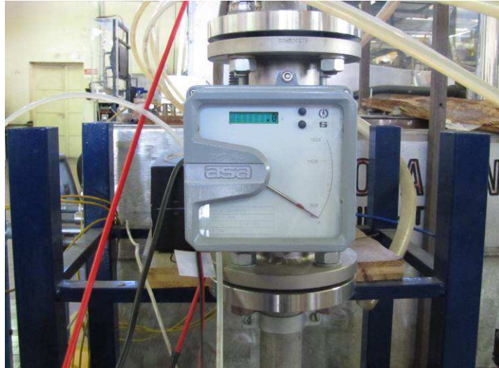
Figura 42: Rotametro per la misura della portata d'acqua totale. Circuito B.
