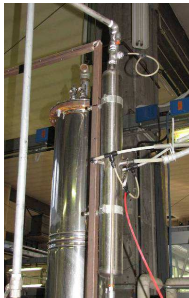
Figura 33: Collettore di scarico delle sezioni di prova. Circuito B.
