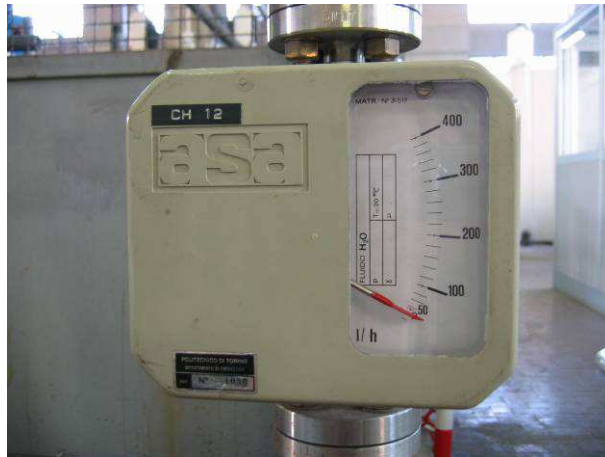
Figura 39: Rotametro 1 per la misura della portata di acqua. Circuito A.
