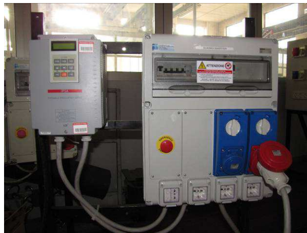
Figura 25: Pompa di alimentazione ed inverter. Circuito B.
