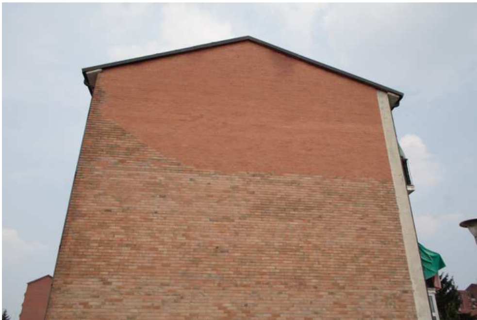
43 Testata Est, evidente il cambio di tessitura dei mattoni per un intervento, probabilmente, al paramento esterno della muratura. Si evidenzia anche una colatura dal tetto.
