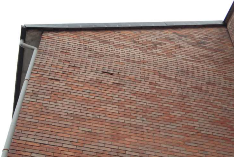
Figura 36 Situazione di degrado, alcuni mattoni sulla testata Nord del fronte Est si sono fessurati, probabilmente perchè gelivi.
