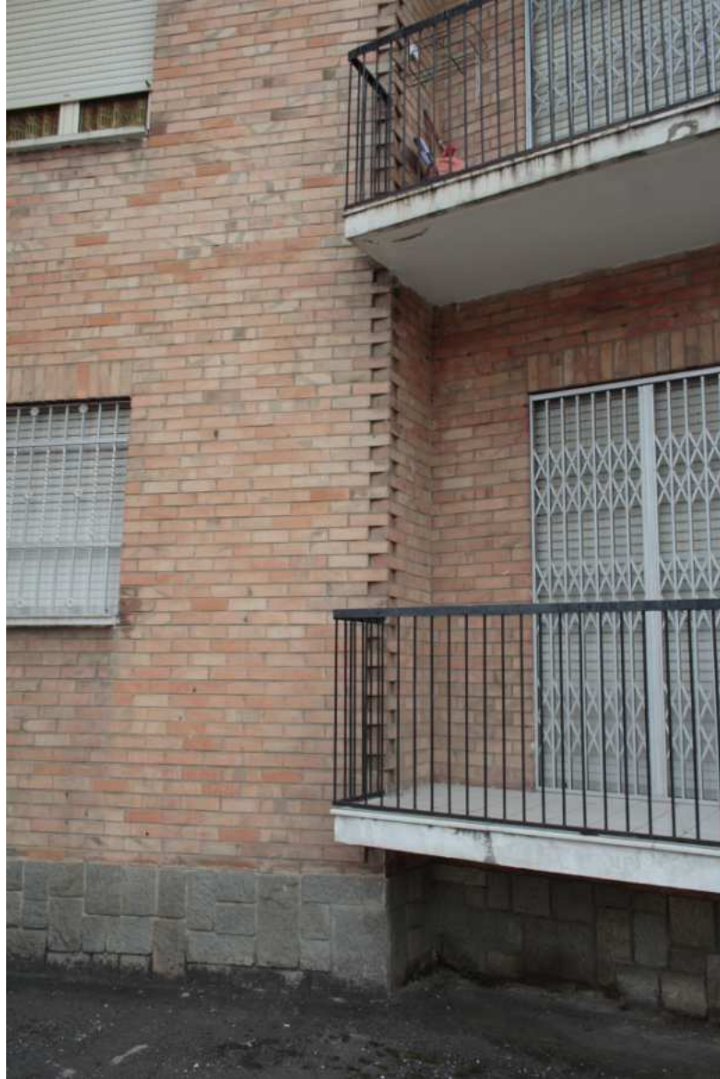
Figura 44 Particolare della soluzione d'angolo, si notano evidenti colature sul perimetro esterno del balcone
