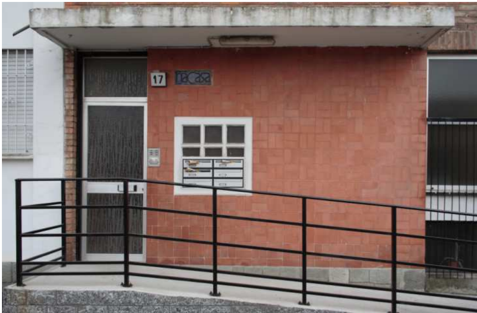
Figura 39 Ingresso fronte Nord, oltre all'inserimento di una rampa e alla sostituzione del portoncino, si nota come la pensilina sia nello stato originale, senza copertina e quindi sottoposta a dilavamento
