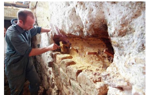
Fig. 4.19, Interventi per il reintegro di materiale alla base di un muro in Bauge nel Parco. (foto da F. Streiff, "Rénovation du bâti en bauge" - Grain d'Isère 2013)
