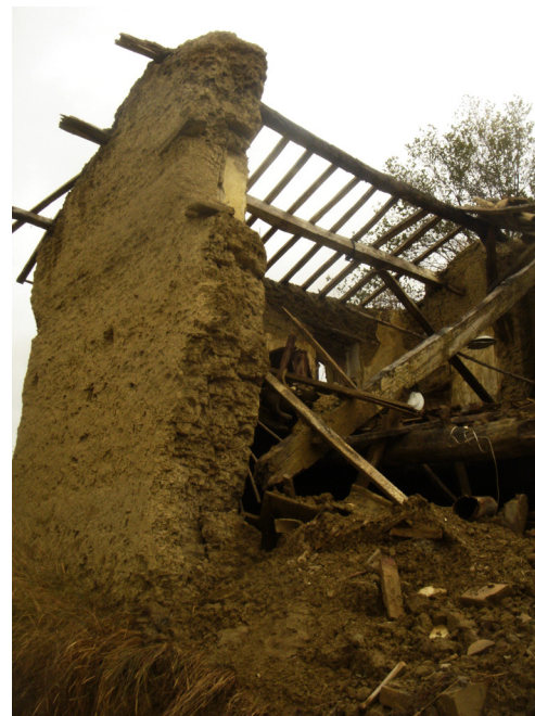
Fig. 4.27, Abitazione fortemente danneggiata a seguito del crollo della copertura. (foto: S. Parlato)
