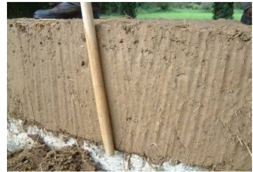
Fig. 4.17, 4.18, Costruzione secondo filare di un muro in bauge, la posa del materiale avviene in senso inverso al filare inferiore; il muro viene poi rifinito tagliando il materiale eccedente e livellando la superficie con il bastone della pala stessa. (foto da F. Streiff, "Rénovation du bâti en bauge" - Grain d'Isère 2013)
