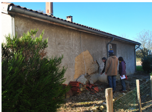
Fig. 3.9, Romans, Rhône – Alpes; Il muro in pisé ha accumulato umidità di risalita a causa del rivestimento esterno a base di cemento. Non potendo evacuare l'umidità in eccesso, la parete ha subito il distacco dell'intonaco. Si è inoltre formata una zona di erosione ben visibile, a causa dei sali portati dall'umidità.
