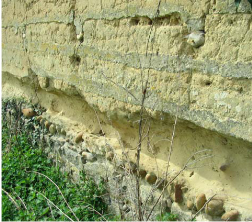
Fig. 5.7, Zona erosa alla base di un muro in pisé in Isère. (foto T. Joffroy, CRAterre)
