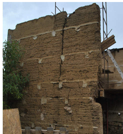
Fig. 5.26, Lesione passante sulla porzione di muro sud ancora integra.
