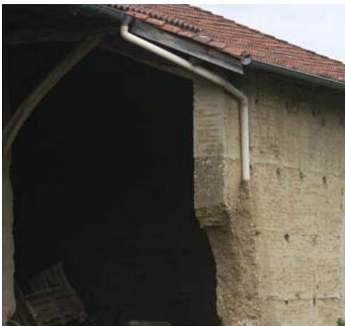
Fig. 5.12, Ruscellamento delle acque di pioggia su una parete in pisé, a causa della rottura del canale di gronda. (foto P. Doat, CRAterre)
