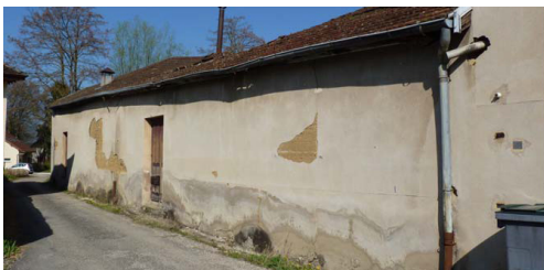
Fig. 5.11, Umidità di risalita capillare e distacco dell'intonaco a causa del drenaggio del manto stradale verso l'edificio, in Savoie. (foto S. Moriset CRAterre, 2012)
