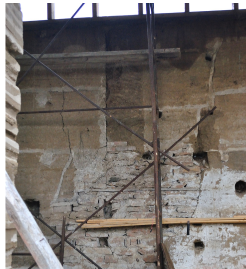
Fig. 5.25, Lesione su muro nord. Si nota sulla sinistra, come la malta nell'interstizio dei filari di blocchi della muratura in terra risulti sfalsata; segno che il muro è stato battuto in momenti diversi.
