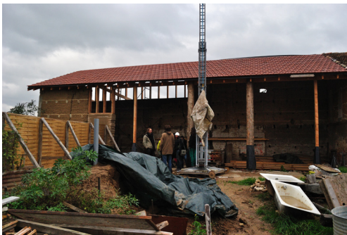
Fig. 5.28, La struttura di copertura completamente ricostruita con nuove travi in legno locale e tegole in cotto, di cui una parte recuperate dal vecchio manto di copertura.
