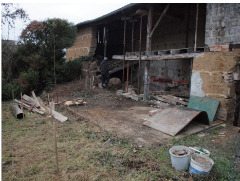
Fig. 5.15, Esperimenti per intonaci a base di terra e fibre su pannello di incannucciato, posato su parete in balle di paglia.
