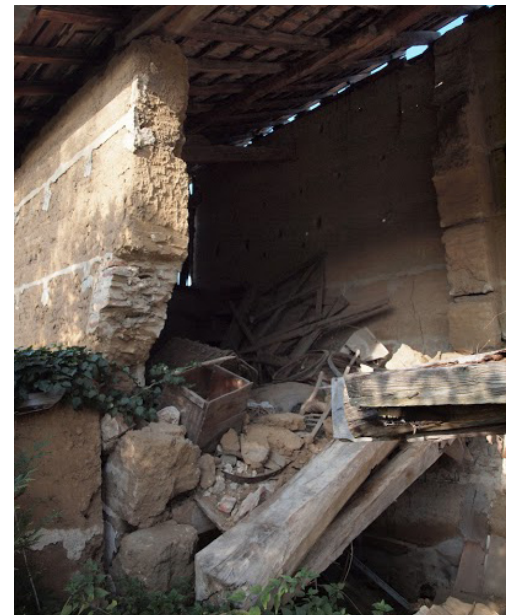
Fig. 5.22, Muro di spina in terra battuta crollato, sono visibili i danni causati al solaio e alla parete perimetrale sud.
