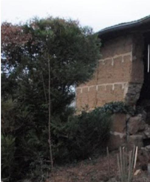
Fig. 5.23, Vegetazione infestante alla base della parete sud, successivamente rimossa.
