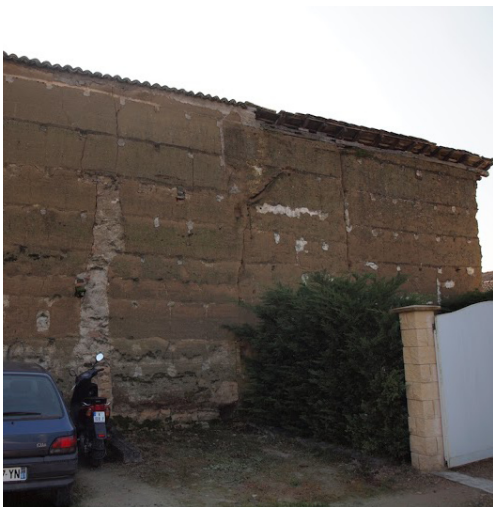
Fig. 5.24, Lesioni sul muro nord. Sulla sinistra si nota una porzione di muro ricostruita in pietra, sulla destra risulta evidente dalle fila di blocchi sfalsati, come l'estremità ovest del muro sia stata costruita in un momento differente
