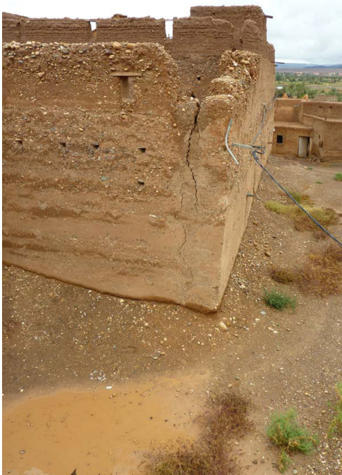
Fig. 5.3, Fessurazione nel giunto angolare, distacco e basculamento parete a causa di ristagni d'acqua sul terreno. (foto S. Moriset CRAterre, Marocco 2011)
