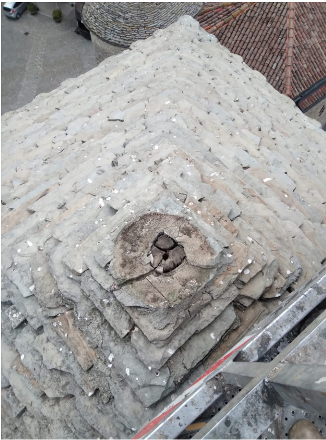
Fig. 3. Monastero Bormida, torre campanaria. Ispezione dell'estradosso della copertura con cestello, controllo della stabilità degli elementi del manto, ricorso e contestuale consolidamento dell'ancoraggio della croce sommitale, 28 luglio 2023.
