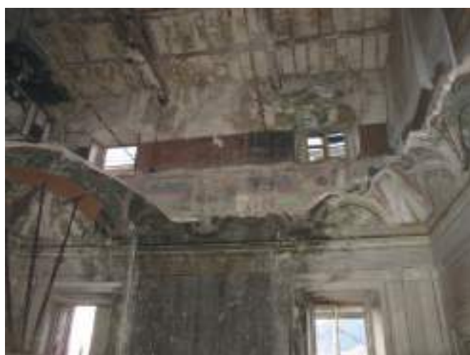
Fig. 7. Terni, volta crollata al piano nobile di villa Palma (foto di G. Castellini Rinaldi, 2018).
