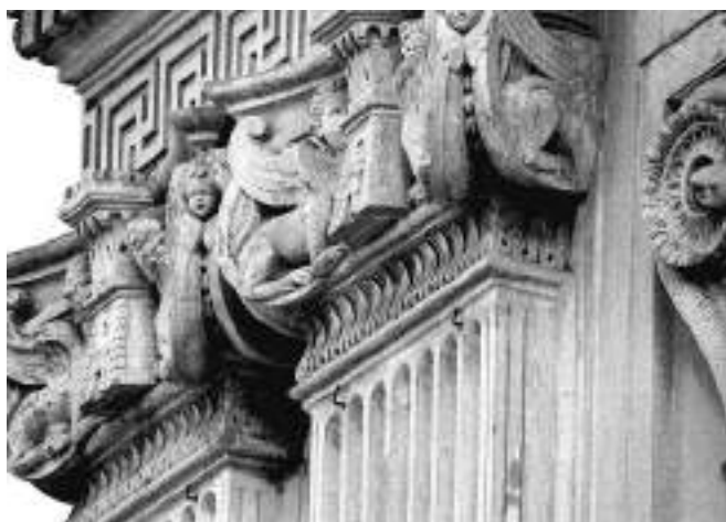
Fig. 14-16. Roma, Santa Maria del Priorato, particolare con gli stucchi della facciata prima e durante l'intervento di restauro del 2017-2019 (foto G. Ferreri).
