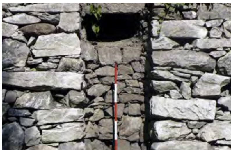
Figura 41 Sbocco di un canale sotterraneo di drenaggio inserito nel muro basale dei terrazzamenti di Rivetto di Pontegrande (comune di Bannio-Anzino). Questi canali, alcuni di origine antica come a Varchignoli in valle Antrona, furono realizzati sino a fine '800 laddove la grande estensione delle superfici terrazzate raccoglie una enorme quantità d'acqua meteorica tale da non essere agevolmente evacuata dall'intrinseco drenaggio naturale del muro.
