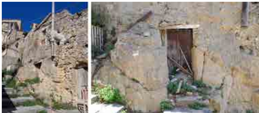
1: Ruderi di alcune case nel quartiere Granfonte a Leonforte (EN).
