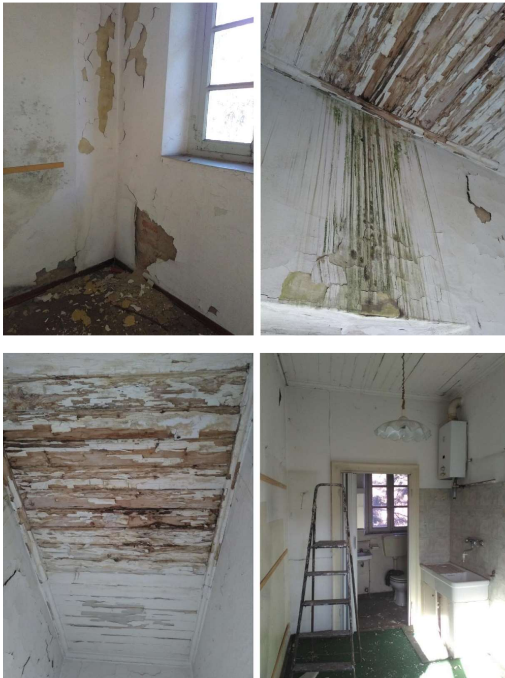
Figg. 5.60-5.63. Villa Dho: stato di fatto casa del custode prima dei lavori (foto M. Russomando, 2016)
