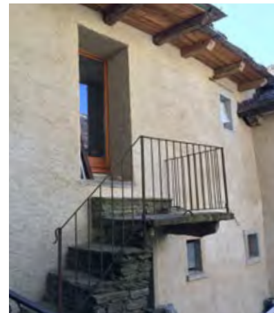
Figura 19 Vista inferiore di nuovi aggetti di gronda con mensole sottoposte. Trontano (VB). Arch. Scotton
