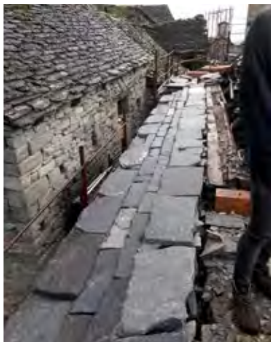
Figura 18 Aggetto di gronda. Piode di partenza e corsi superiori. Veglio - Montecrestese (VB). Arch. Scotton
