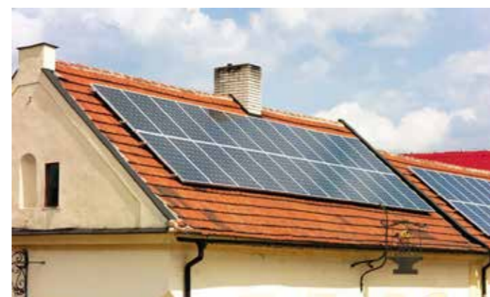
Pannelli solari da https://www.edilportale.com
