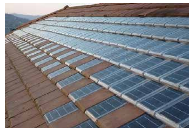
Copertura con tegole fotovoltaiche da: https://www.lavorincasa.it
