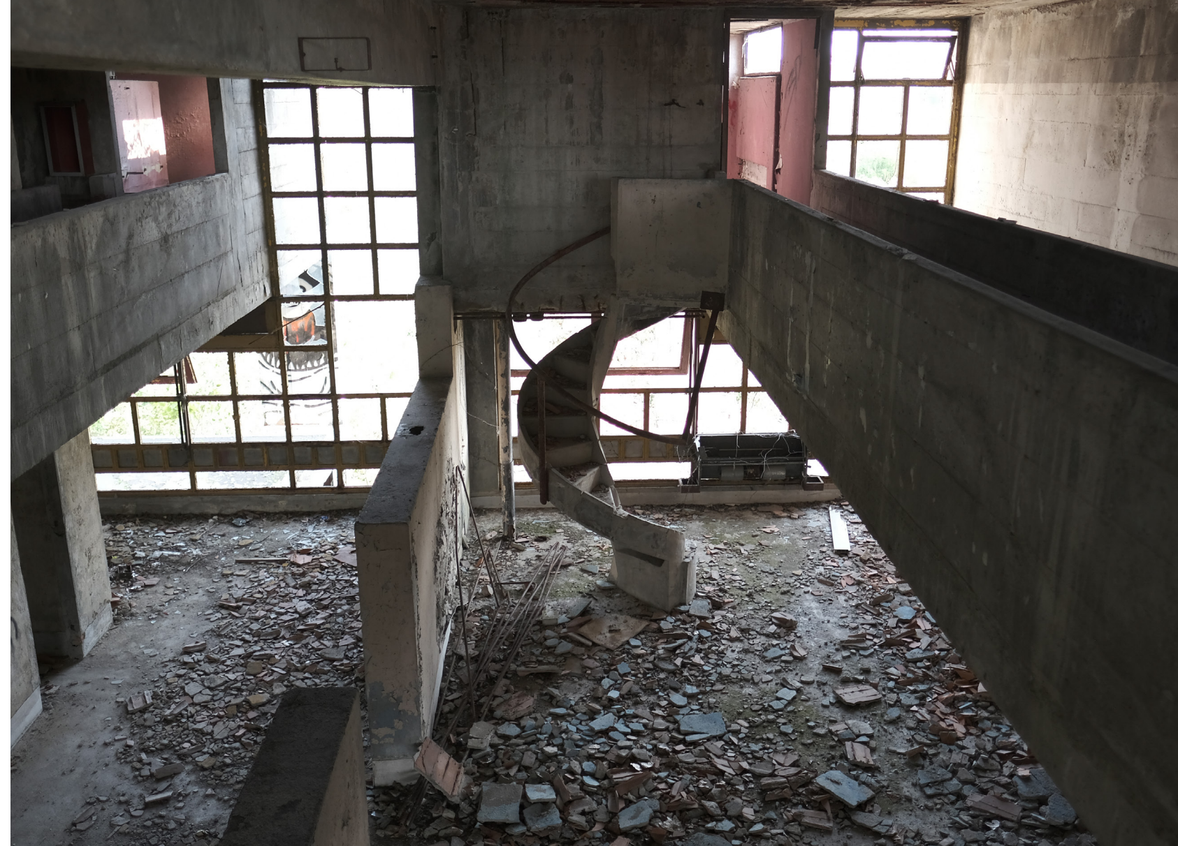
Vittoriano Viganò, Istituto Marchiondi-Spagliardi , Baggio, Milano. La stanza da letto nel padiglione-convitto vista dal piano superiore. Foto di Maurizio Villata (2023)
