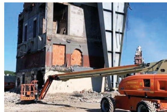
Fig.8-10 - Lo smontaggio della trave a sbalzo e la progressiva demolizione dell'autogrill di Montepulciano, 2021 (fotografia dell'autrice)
