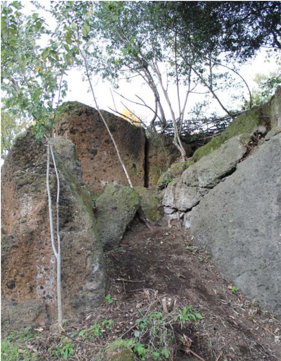
(Fig. 6.61-6.68) Nella pagina precedente. Varie situazioni di crescita di nuova vegetazione all'interno di plessi fessurativi preesistenti o discontinuità nel materiale. Ciascuna di queste piante, se non eliminata per tempo potrebbe essere causa di danneggiamenti per le strutture
