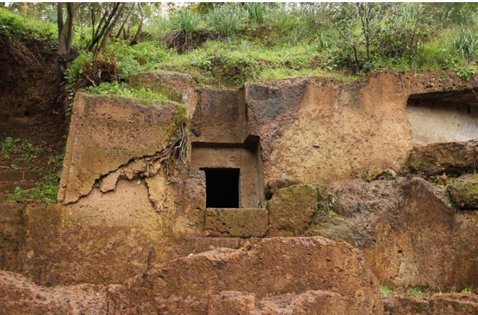
(Fig. 6.17) Le fessurazioni aggravatesi dopo l'esposizione delle strutture
