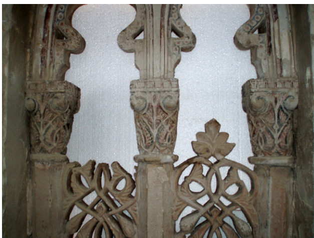
Fig. 3. Magallón (Spagna). Ex-chiesa di Santa Maria del la Huerta, consolidamento delle rovine e trasformazione in auditorio, dettaglio della protezione delle finestre durante il cantiere (foto I. Ruiz Bazán 2007).
