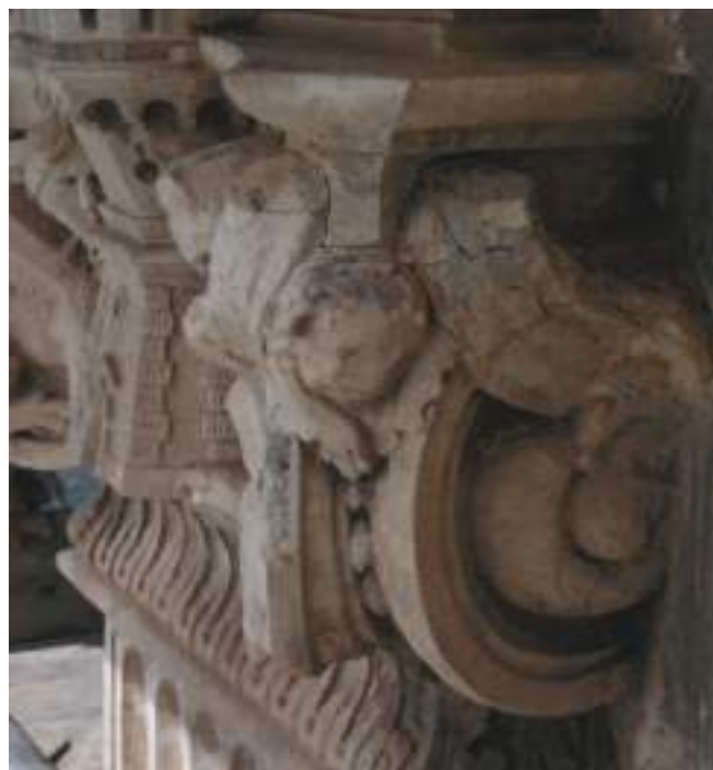
Fig. 19. Roma, Santa Maria del Priorato, particolare con gli ornati in stucco dei capitelli della facciata prima dell'intervento di restauro del 2017-2019 (foto G. Ferreri).
