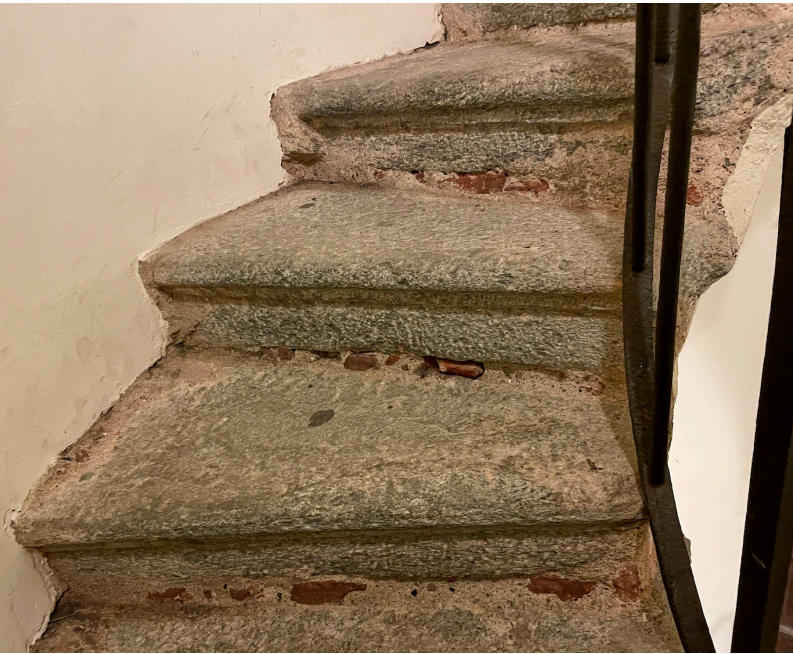
Fig. 9. Basilica di Superga , Torino, scala di salita alla cupola: gradini in serizzo con appoggio imperfetto, assicurato da frammenti di mattoni e malta [fotografia dell'autore].
