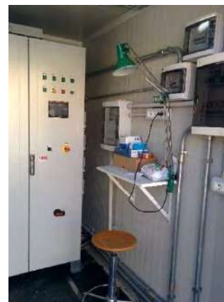
h) PLC – pannello di controllo
