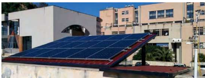
a) pannelli fotovoltaici
