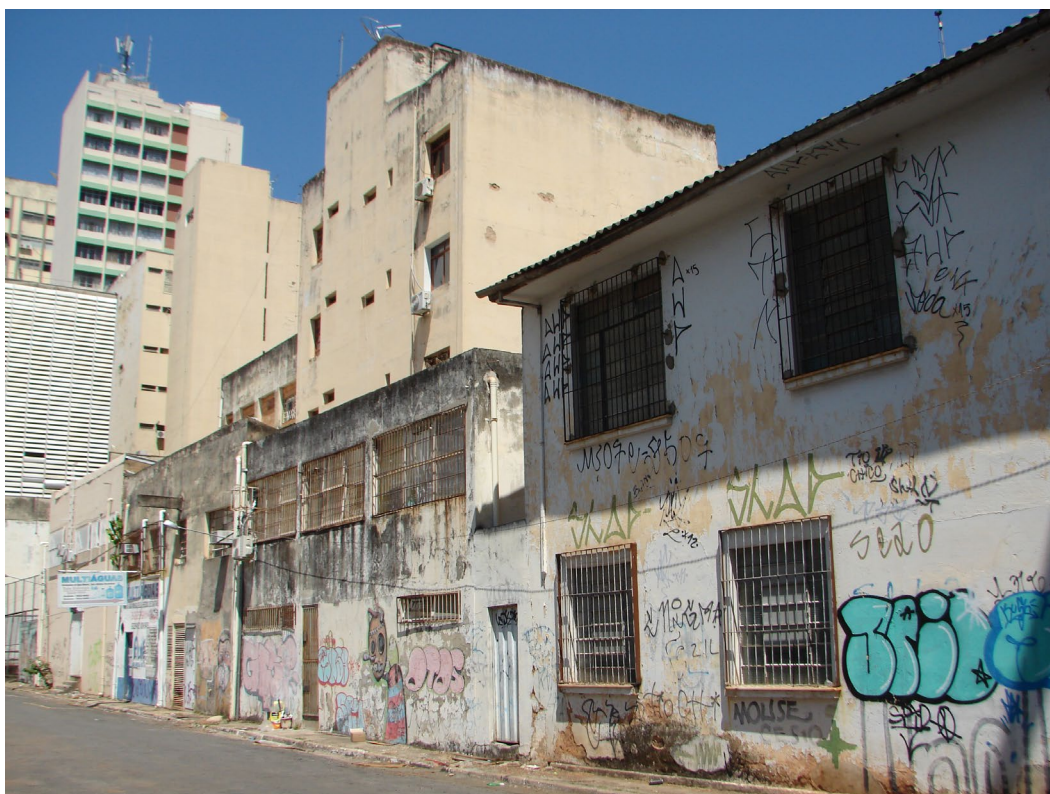
Figura 6. Condição de degradação edilícia no beco da Quadra 4, esquina com Avenida Goiás, Setor Central. Fonte: Acervo dos autores, 2017. Fotografia: Ivan Oliveira de Grande, dez. 2017.
