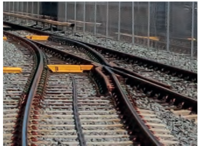
Figura 11 – Deviatoio con cuore mobile in stazione di Bekkestua. Figure 11 – Switch with movable crossing at Bekkestua station.
