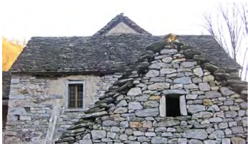
Figura 2 Ripresa di muro costruito a secco (in primo piano) e di muro con giunti di malta (in secondo piano) di due edifici di Veglio, frazione di Montecrestese.
