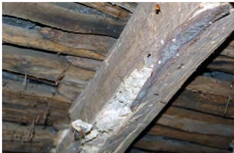
Figura 5 Travatura principale vistosamente attaccata da insetti xilofagi e funghi di caria bianca. La capacità strutturale di resistenza risulta compromessa.
