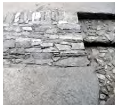
Figura 18 Selciato moderno: scalinata di accesso a un rustico riattato ad abitazione per vacanze, La Fraccia, Trasquera, Valdivedro. 2011 (architetti Gianni Bretto e Andrea Scotton).
