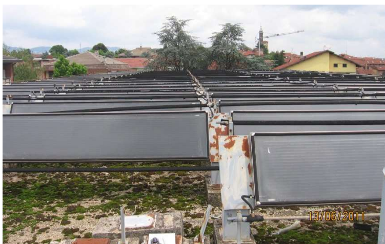
Fig. 14 – Cambiano (Torino), pannelli solari termici abbandonati sulla copertura dell'edificio scolastico
