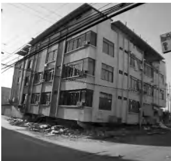
Foto 6. Ejemplo clásico de piso blando. Fuente: autores
