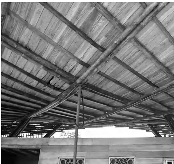
Figura 9. Apuntalamiento provisional de la cubierta por riesgo de colapso en febrero de 2020. Fuente: archivo de los autores
