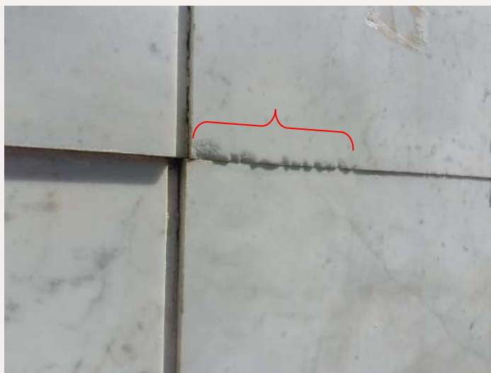
Fig. 8. Dettaglio di un prospetto verticale esterno, rivestito in marmo bianco cristallino, posato a malta cementizia. La parentesi graffa indica una fascia dove si concentrano numerose "sbeccature" alla base di una lastra. Vedi testo.
