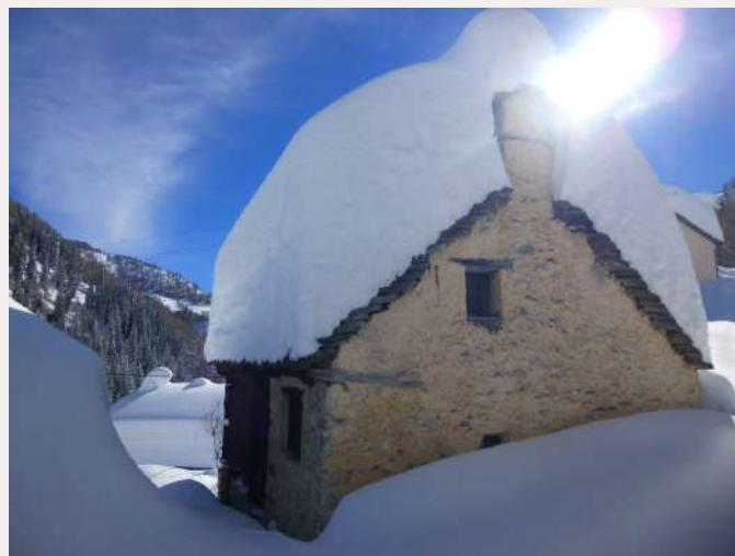
Fig. 7. Un carico nevoso eccezionale su un tetto in "lose" rappresenta un esempio di carico statico, transitorio. Valle Antrona (Piemonte)
