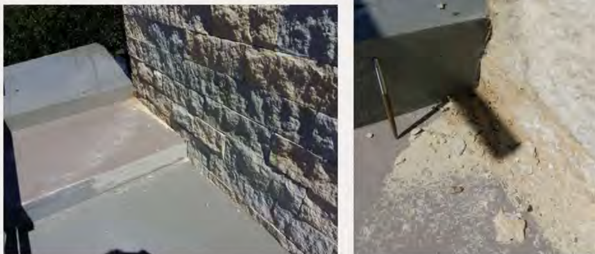
Foto 2-3: sinistra: profonda disgregazione di un calcare installato su rivestimento parietale. I fenomeni intensi e ad evoluzione particolarmente rapida (l'immagine di destra è stata scattata tre mesi dopo quella di sinistra) sono dovuti sia alla struttura fortemente porosa del calcare, sia all'aggressività dell'atmosfera salina, sia alle frequenti alternanze gelo-disgelo. Pitgrudy (Scozia)
