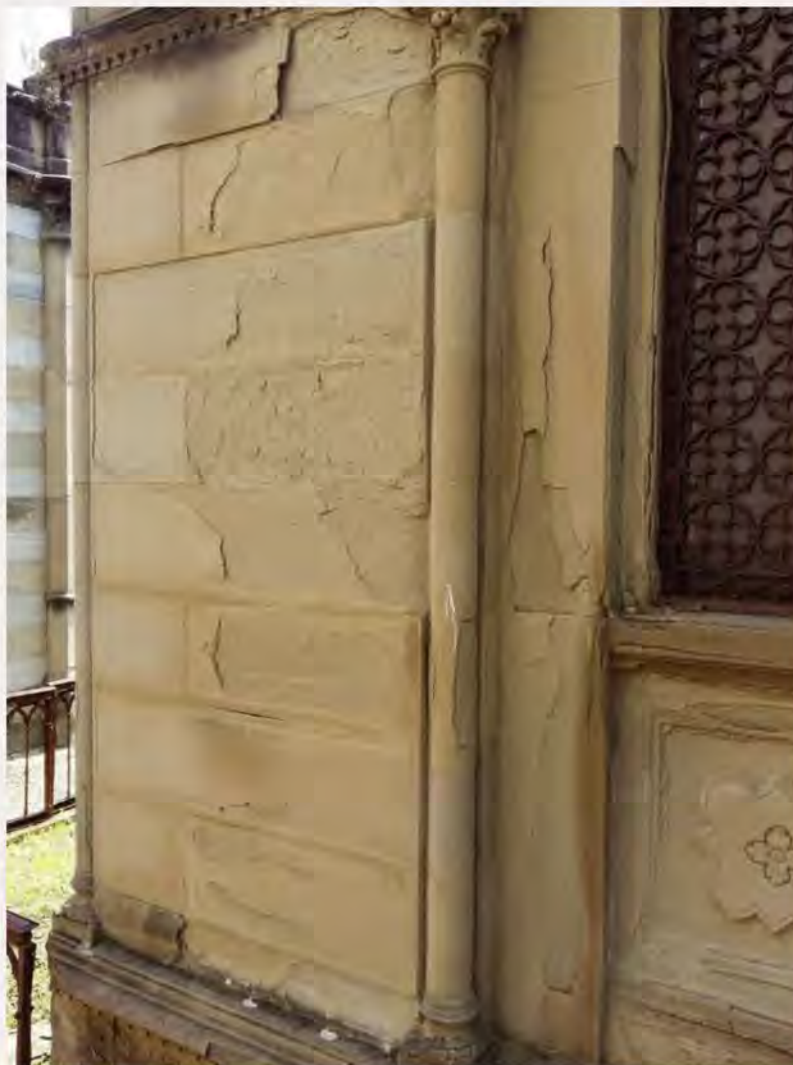
Foto 1: Degrado esteso in lastre parietali di arenaria, con disaggregazioni, esfoliazioni, scagliature e distacchi (Vienna, Austria). L'arenaria interessata è contraddistinta da elevati valori di porosità aperta e totale (test secondo EN 1936) nonché da numerose porosità intercomunicanti (esame petrografico secondo EN 12407)
