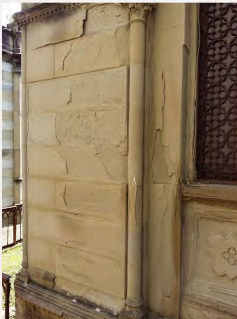
Foto 1: Degrado esteso in lastre parietali di arenaria, con disaggregazioni, esfoliazioni, scagliature e distacchi (Vienna, Austria). L'arenaria interessata è contraddistinta da elevati valori di porosità aperta e totale (test secondo EN 1936) nonché da numerose porosità intercomunicanti (esame petrografico secondo EN 12407)
