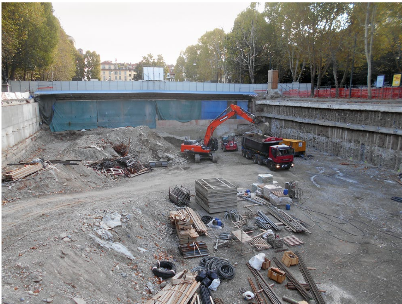
Torino, piazza Arbarello. Veduta del cantiere Ireti per la realizzazione della cabina elettrica primaria di trasformazione.
