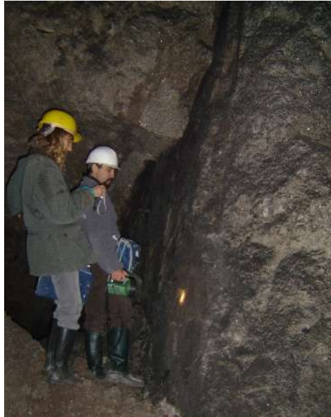
Fig. 3. Esempio di discontinuità strutturale riconosciuta in una cava di gesso in sotterraneo abbandonata.
