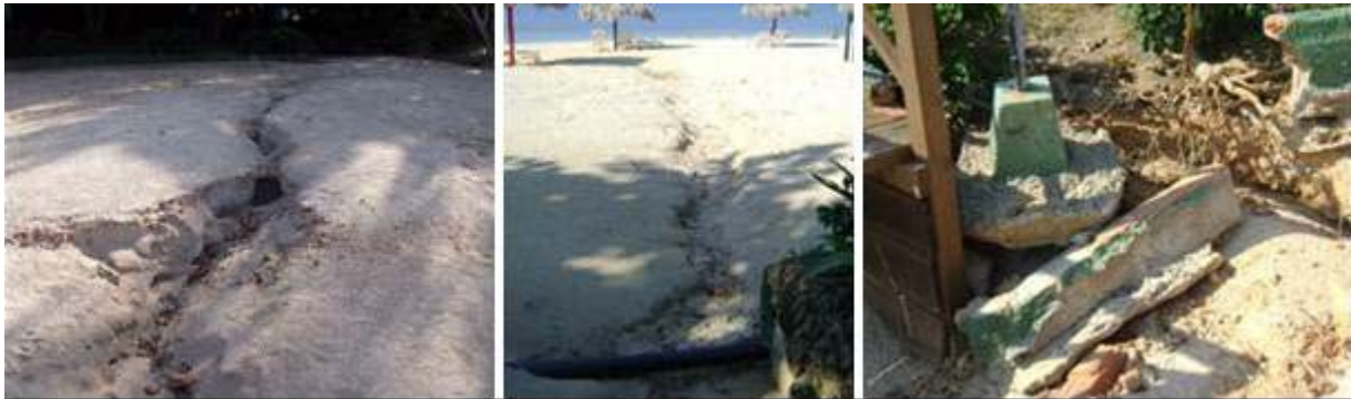
Figura 3. Evidencias erosivas en la berma de la playa y áreas verdes contiguas a los estratos 1 y 2 (Fuente: Elaboración propia)
