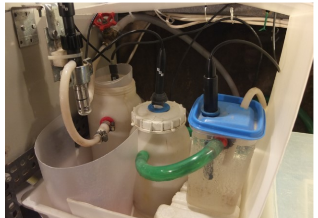
Foto 15 – I sensori per il monitoraggio di pH, Ossigeno disciolto, conducibilità elettrica
