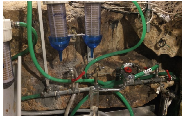
Foto 14 – Filtri e tubazioni che portano le acque in laboratorio
