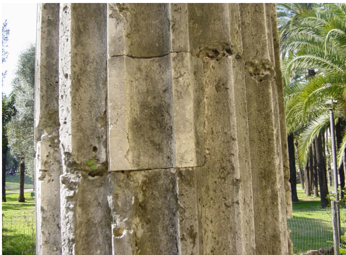
Figura 25, Rudere di ninfeo a villa Torlonia, particolare del tassello di “falso restauro” in una delle colonne, 2003 (foto dell'autore).
