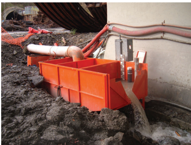
Fig. 11 - Stazione di misura della portata drenata all'imbocco di una galleria in costruzione.
