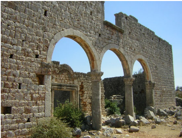
Figura 9. Kanytelleis. Veduta della basilica D; tutti gli edifici mostrano interessanti esempi di dissesto strutturale o di crolli primari ancora ben conservati (foto E. Romeo, 2005).
