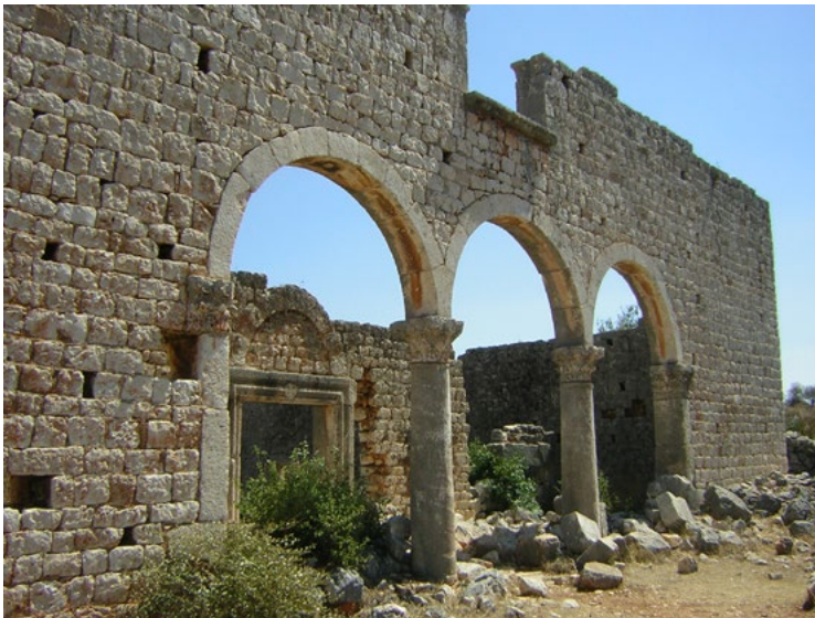
Figura 9. Kanytelleis. Veduta della basilica D; tutti gli edifici mostrano interessanti esempi di dissesto strutturale o di crolli primari ancora ben conservati (foto E. Romeo, 2005).
