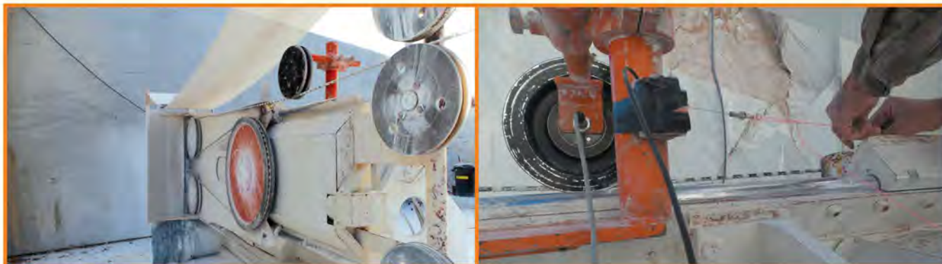
Fig.9 A sinistra, posizionamento cella di carico sull'Apuania Corsi MF 5000; a destra, installazione dell'estensimetro a filo Left, positioning of the load cell on the Apuania Corsi MF 5000; right, installation of draw wire encoder
