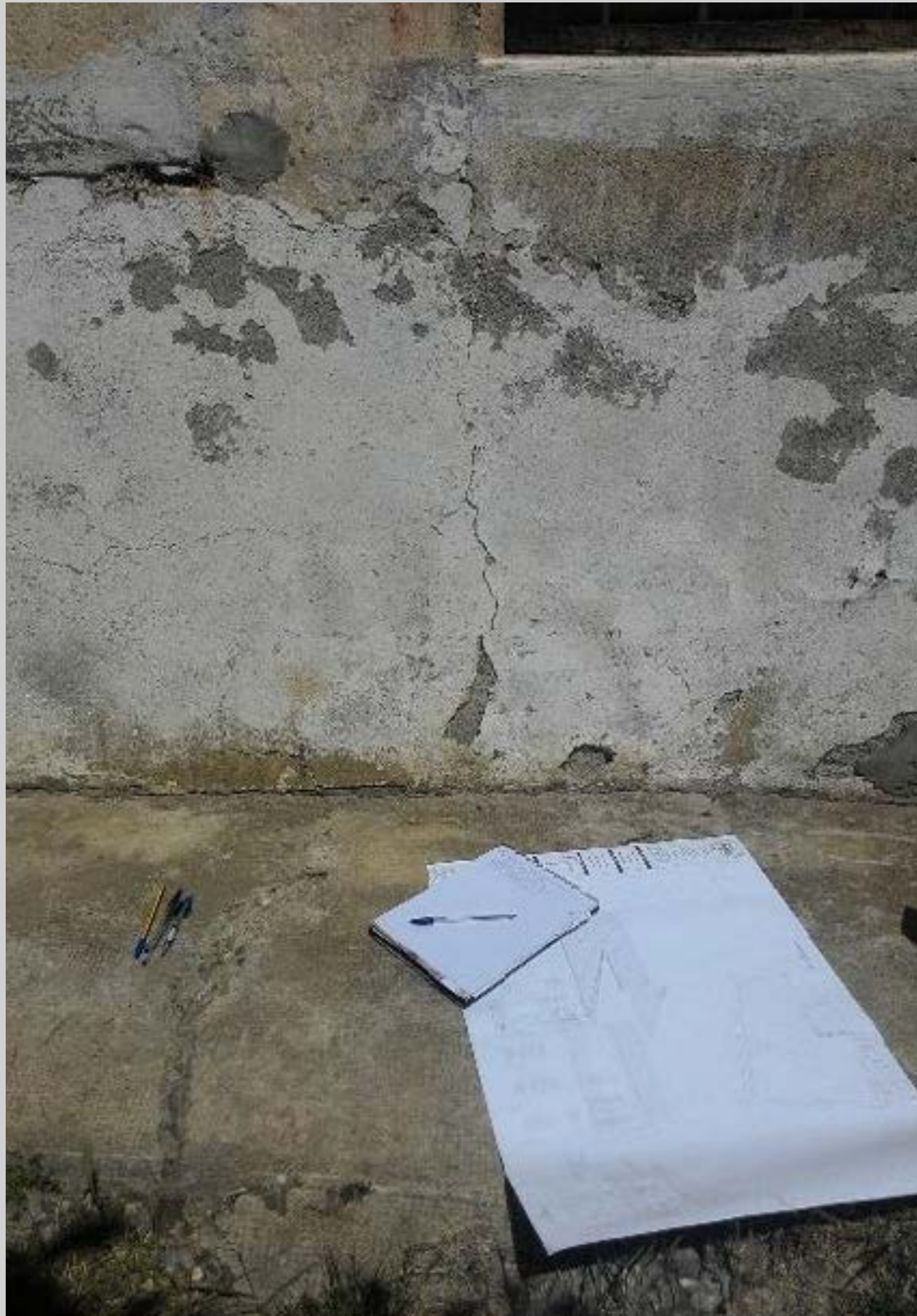
Rilevando il degrado, A. Vigni
