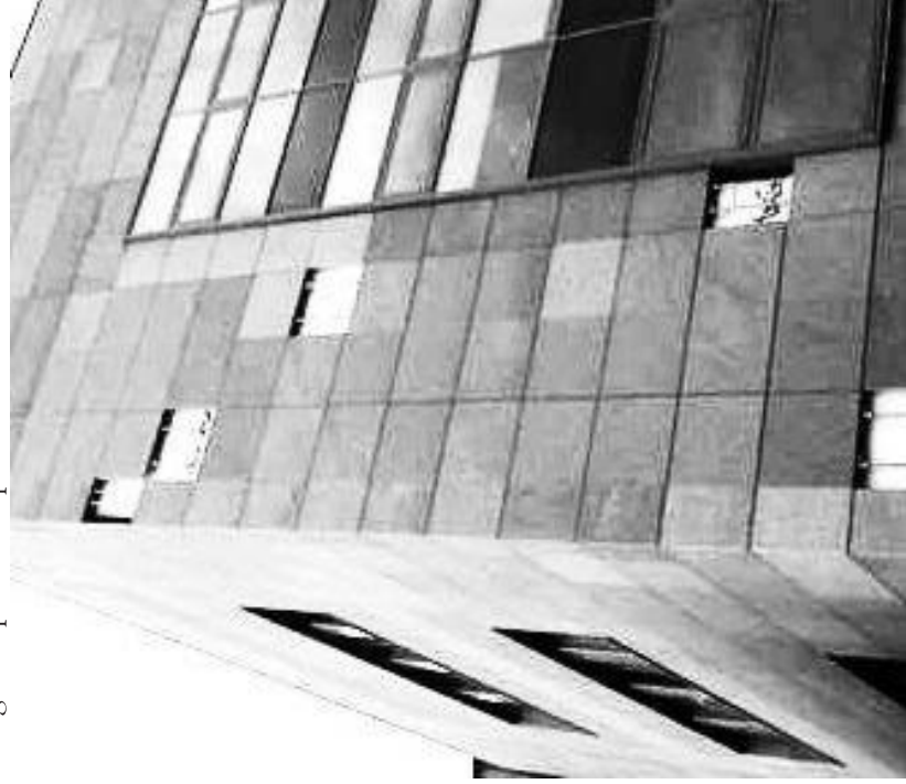
Fig. 2. Esempio di Gruppo formato da 50 lastre (10 righe per 5 colonne). Nell'immagine alcune lastre rimosse a seguito di controllo; è visibile la sottostruttura portante.
