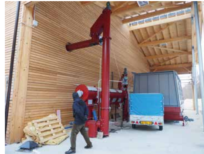
3. Stabilimento GestAlp, Frassino (CN): l'impianto di cippatura dei tronchi sotto la tettoia esterna. Foto Takao Ozasa, 2014.
