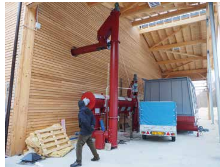
3. Stabilimento GestAlp, Frassino (CN): l'impianto di cippatura dei tronchi sotto la tettoia esterna. Foto Takao Ozasa, 2014.
