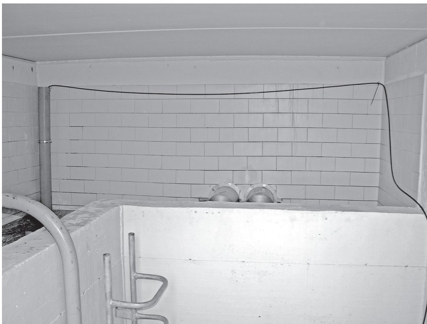
Fig. 3. Opera di presa e posizionamento della sonda protetta da un tubo in PVC. Tapping system and probe installed in a PVC pipe.
