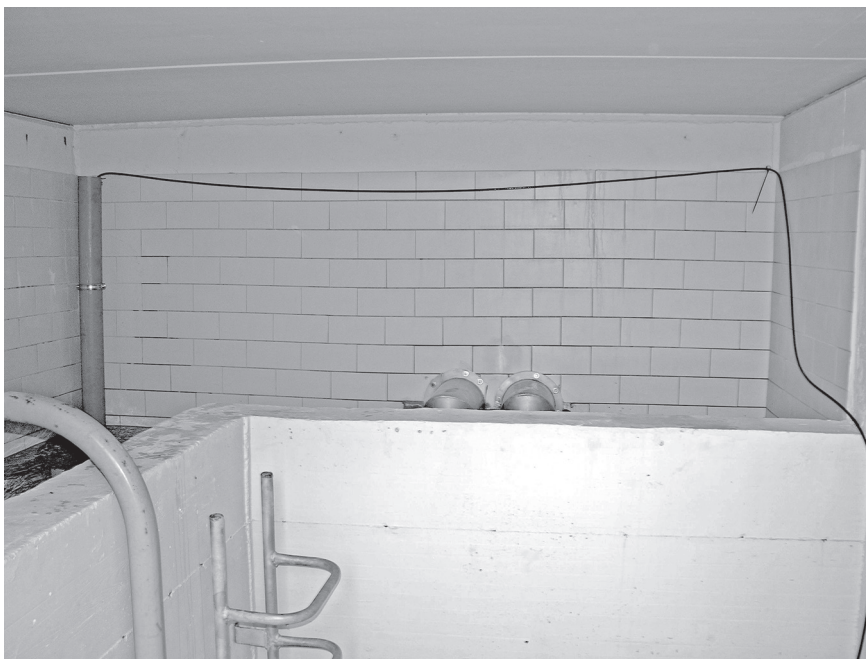
Fig. 3. Opera di presa e posizionamento della sonda protetta da un tubo in PVC. Tapping system and probe installed in a PVC pipe.
