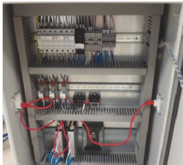
Fig. 2. Control module cabinet.
